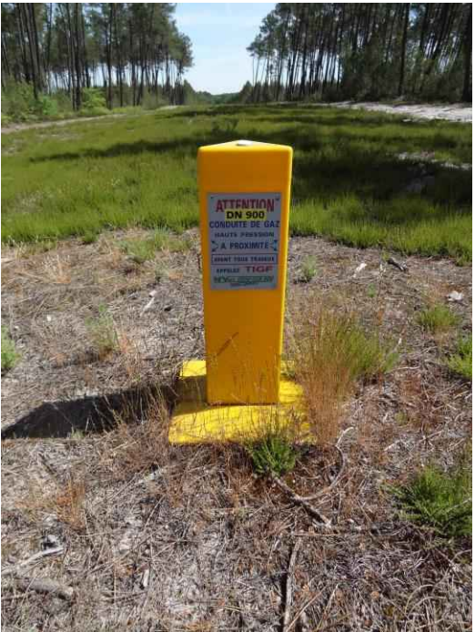
Figure 6: Canalisation de gaz au niveau de Cudos (Source : EGIS 2012)
